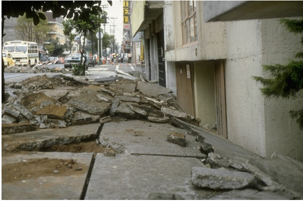
Figure 1. Rupture par perte de capacité portante après le séisme de Guerrero – Michoacán (Mexique, 1985).
